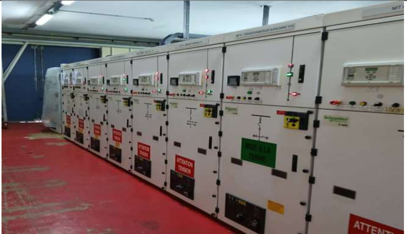
Vue partielle des installations du poste de Bobo 2, 22 juillet 2024
