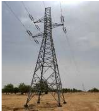
Voie de la maintenance de la ligne existante 132 KV
